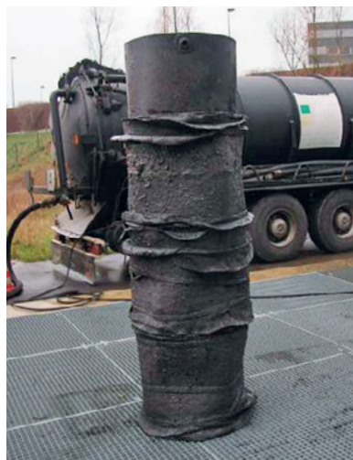
Verstopfter Koaleszenzfilter: Wasserableitung ist gestört, Abscheiderentsorgung und Wartung erforderlich
