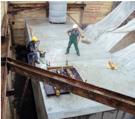
Einbaubeispiel: Löschwasserbehälter 100.000 l, Universität Mainz
