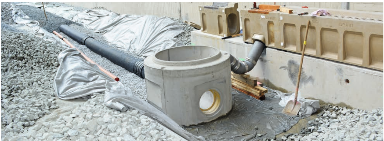
Anschlüsselement mit Rohrsiphon zum Revisionschacht und Anschluss an die Längsentwässerungsleitung
