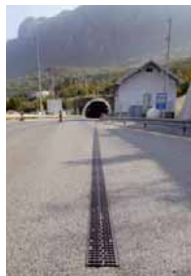
ACO MultiDrain - Tunel Sozina, Crna Gora
