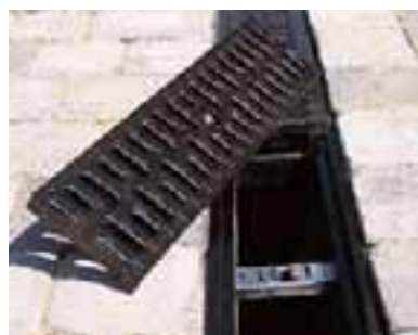
Rešetke na revizionim oknima omogućavaju jednostavno čišćenje kanala
